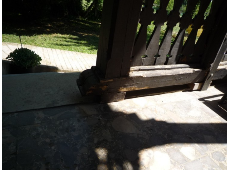
A talpgerenda károsodása és oszloperősítés
